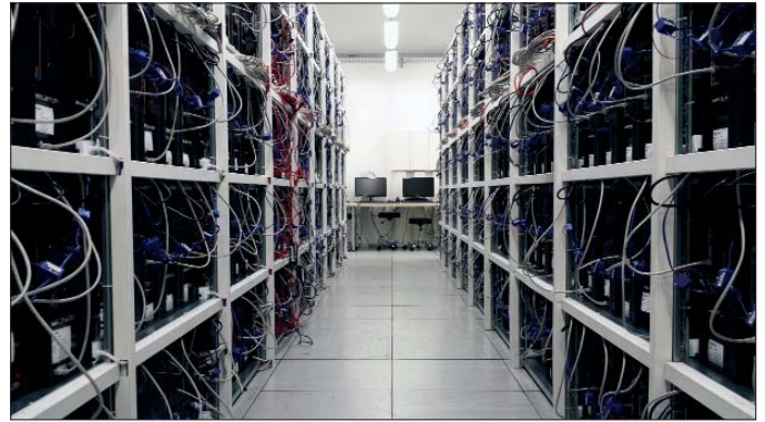
Die Internetserver von Contabo im Nürnberger Rechenzentrum. Als Hostler bietet dieser Provider auch Rechenkapazitäten auf eigenen Servern an. Dieses RZ ist derzeit mit knapp 20 x 10 Gbit/s mehrfach redundant an das Internet angeschlossen: über zwei unterschiedliche Hauseinführungen an mehrere Provider wie Centurylink, Telia oder Versatel (Foto: Contabo)
