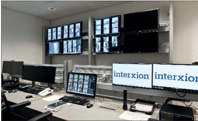
Das Security Center von Interxion in Düsseldorf zur Überwachung von Türen, Schleusen und Gängen (Foto: Interxion)
